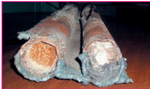
Рис. 6. Поперечное сечение экранных труб котла полностью забито отложениями накипи
